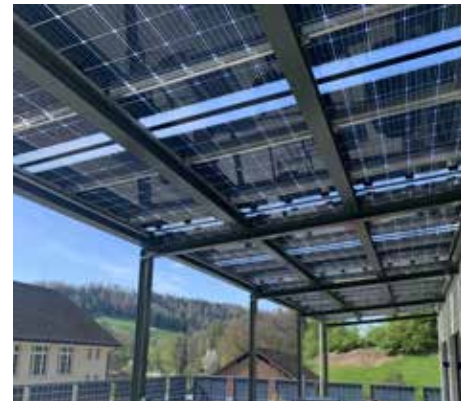
Abb. 1: Die EW Wald AG hat fast jede verfügbare Fläche mit PV-Modulen ausgerüstet.
