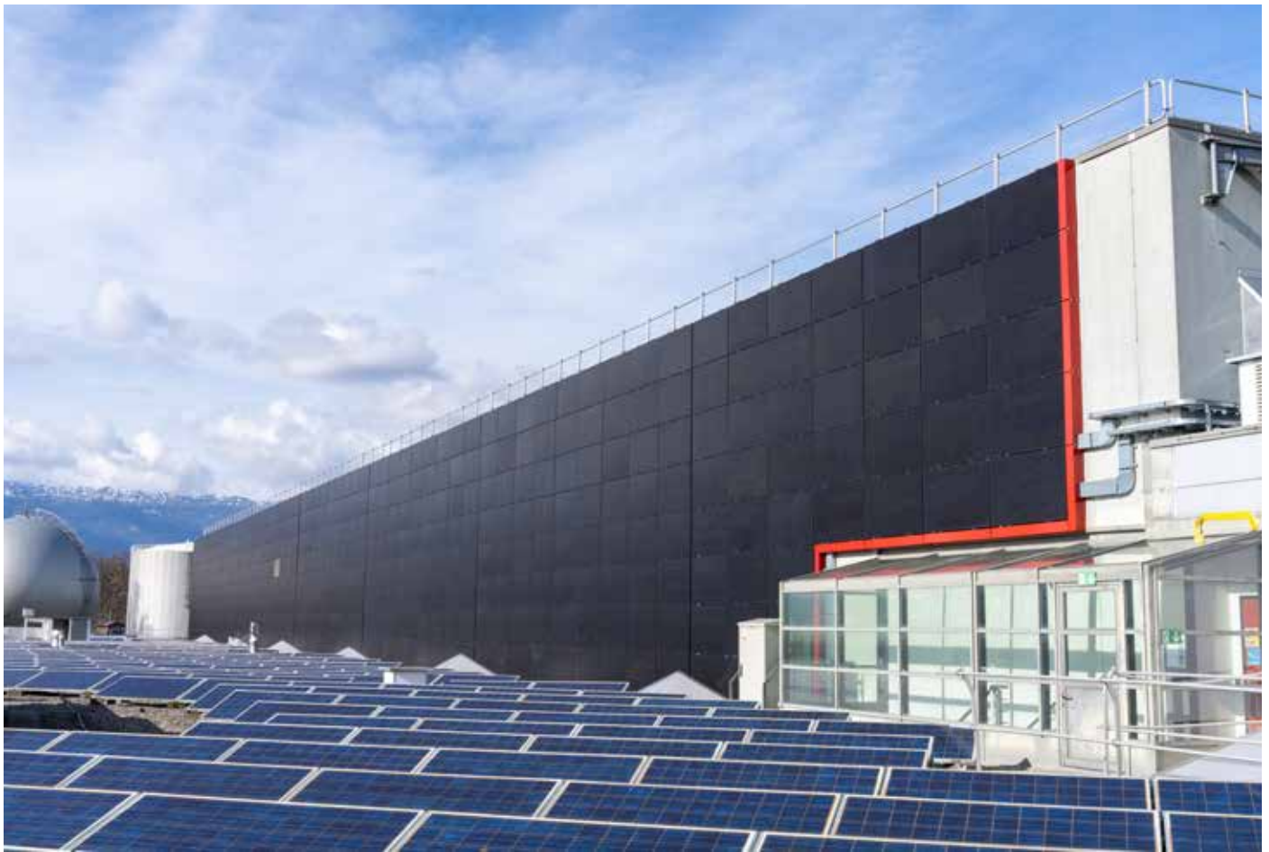
Fig. 2 : la façade solaire de la SIG au Lignon marque une étape importante dans l'exploitation des façades comme surface de production d'énergie solaire. Elle constitue la plus grande façade solaire de Suisse romande.
