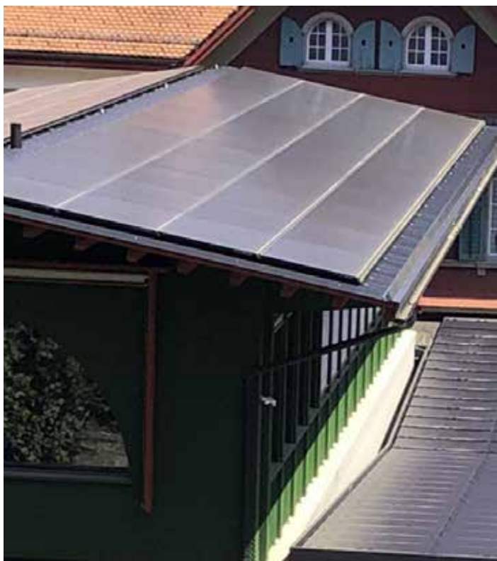
Abb. 3: Auf dem Dach vom Neubau Remise sorgen die ostseitigen Hochleistungsmodule bereits am frühen Morgen für genügend Sonnenenergie zur Eigenversorgung des Bürogebäudes.
