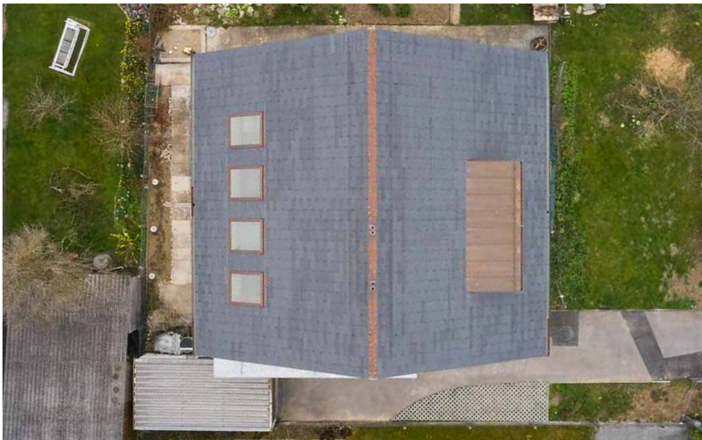
Abb. 1: Das Dach des MFH wurde grosszügig und in sehr sorgfältiger Art und Weise mit PV-Modulen bestückt.
