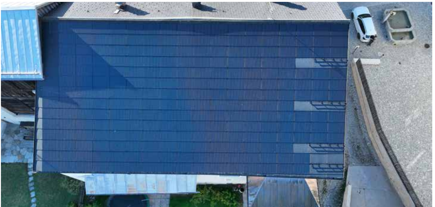
Abb. 3: Die Dachfläche des Gebäudes aus der Vogelperspektive veranschaulicht beeindruckend, wie das Dach mit Photovoltaikmodulen bestückt wurde.
