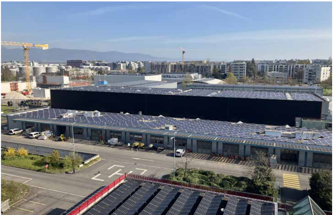
Fig. 3 : depuis 2009, les SIG développent le solaire photovoltaïque sur leur site du Lignon. Aujourd'hui, ce site atteint une puissance installée de 2,4 MWc et constitue un modèle de référence en Suisse romande.
